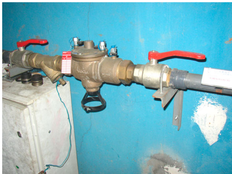
Disconnecteur sur l'arrivée d'eau potable
