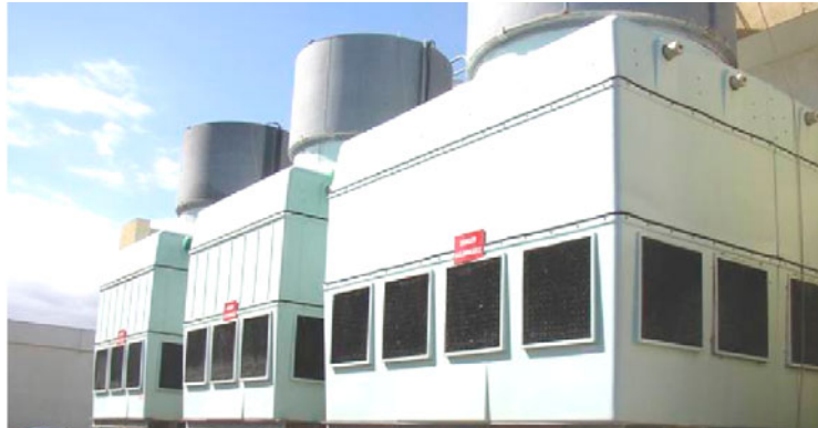
Les trois tours aéroréfrigérantes de l'installation
