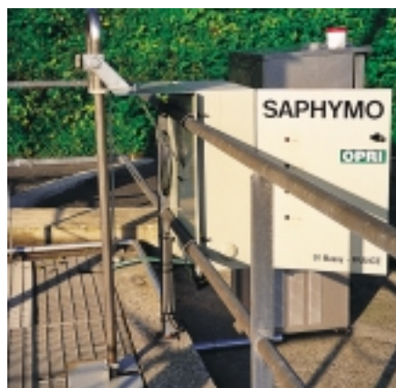
Coffret de commande.
